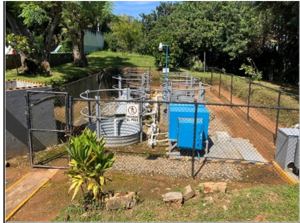
103.- TRATAMIENTO DE AGUAS RESIDUALES.
