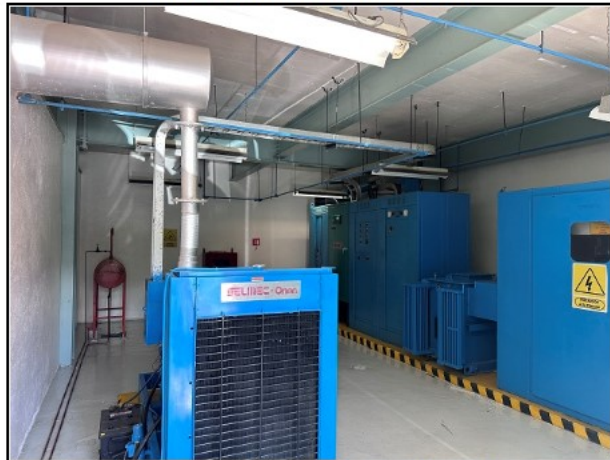
140.- TOMA DEL AREA DE SUBESTACION.
