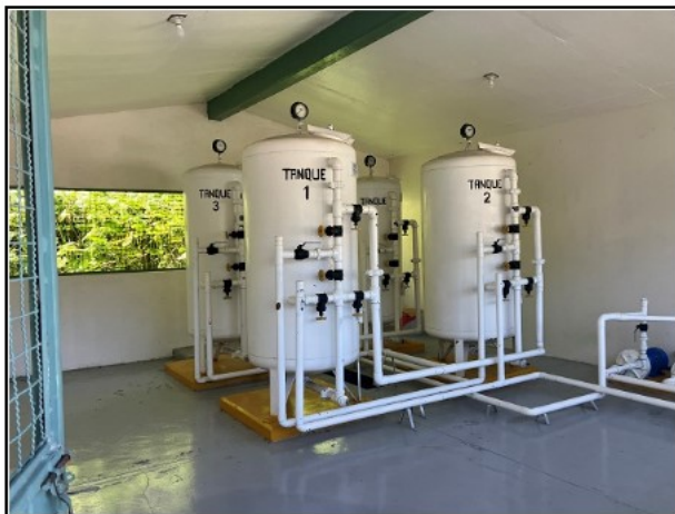
124.- INTERIOR DE LA PURIFICADORA DE AGUA.
