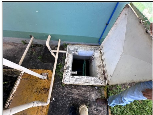
125.- VISTA DE LA CISTERNA.
