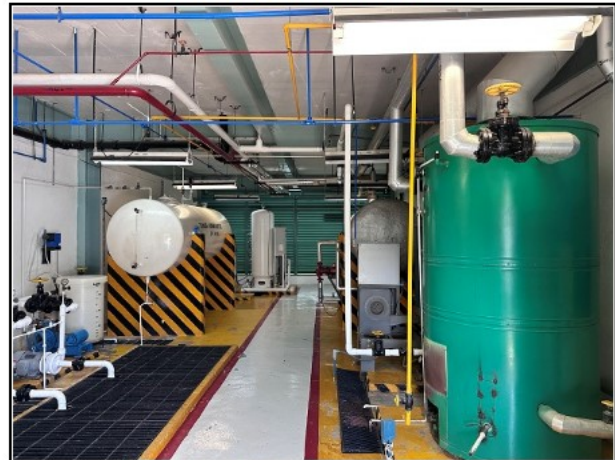
141.-VISTA DEL INTERIOR DE CASA DE MAQUINA.
