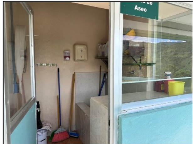
147.- TOMA DEL CUARTO DE ASEO.
