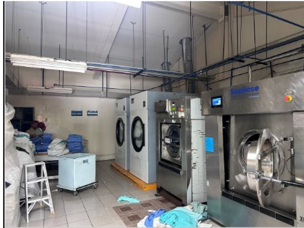
144.- INTERIOR DEL AREA DE LAVADO.
