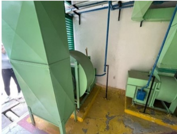
CUARTO DE MÁQUINAS
