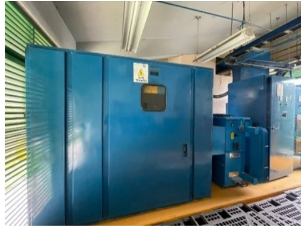
VISTA CUARTO DE MÁQUINAS
