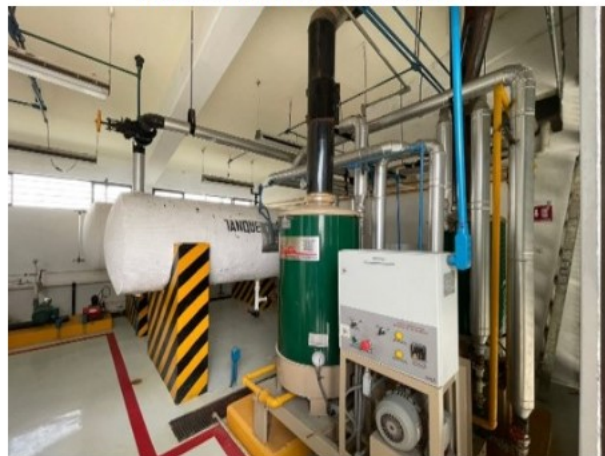
VISTA CUARTO DE MÁQUINAS
