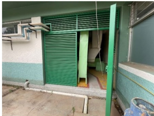
CUARTO DE MÁQUINAS
