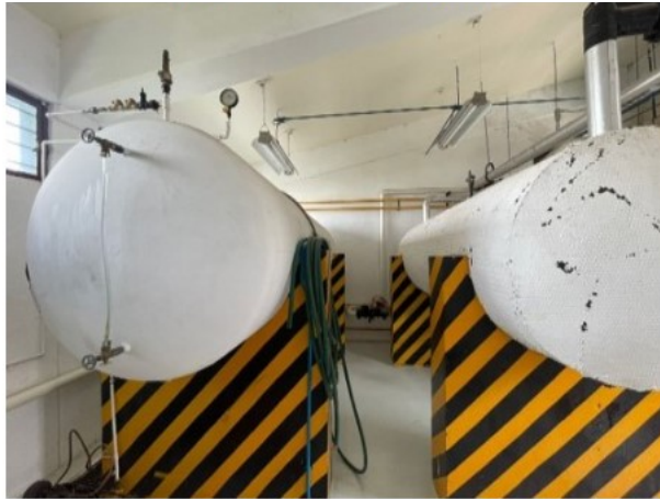
VISTA CUARTO DE MÁQUINAS
