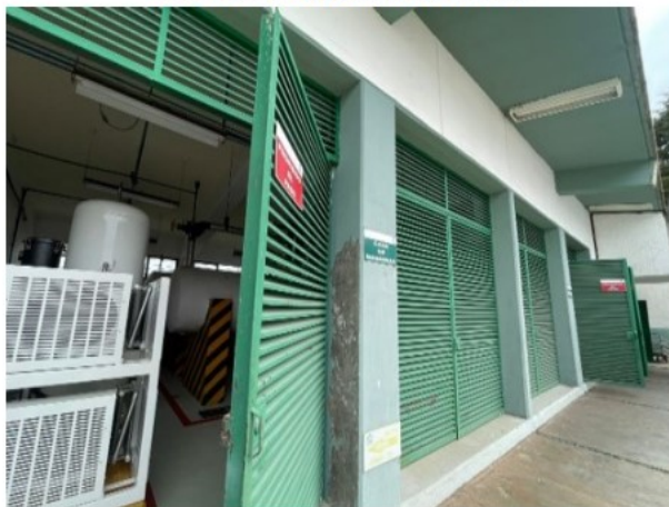
VISTA CUARTO DE MÁQUINAS
