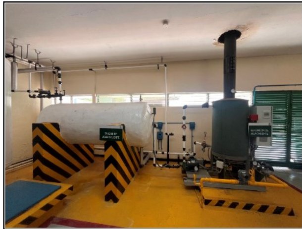
Generador de agua caliente y su tanque
