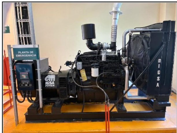
Planta de Emergencia
