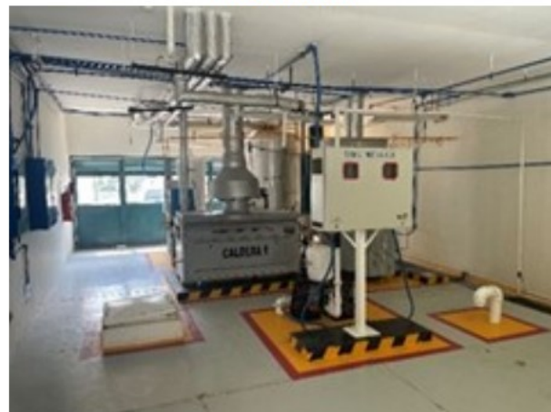
CUARTO DE MAQUINAS
