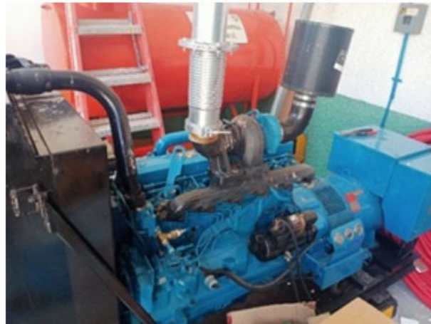
PLANTA DE EMERGENCIA
