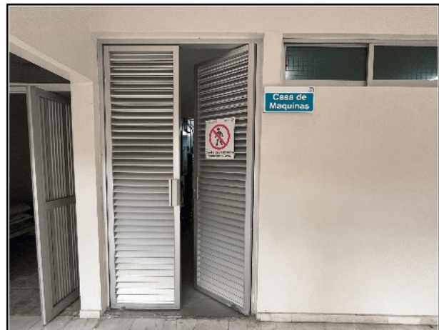
CUARTO DE MÁQUINAS
