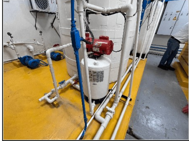
INTERIOR CUARTO DE MÁQUINAS
