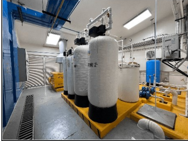
INTERIOR CUARTO DE MÁQUINAS
