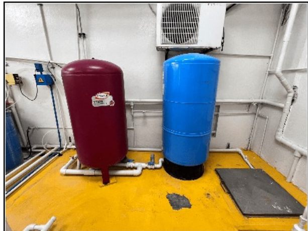
INTERIOR CUARTO DE MÁQUINAS
