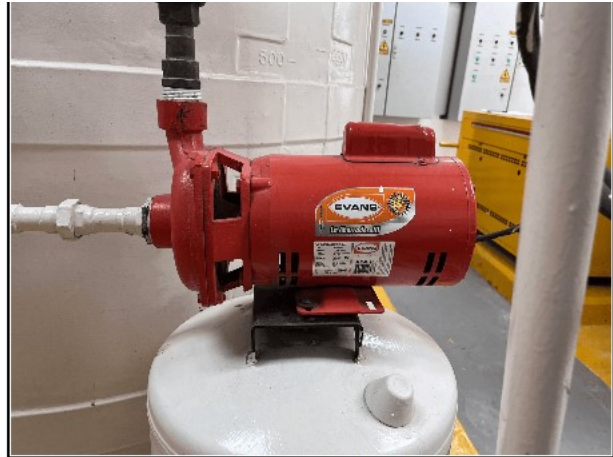
INTERIOR CUARTO DE MÁQUINAS
