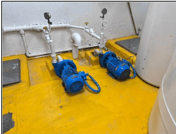
INTERIOR CUARTO DE MÁQUINAS
