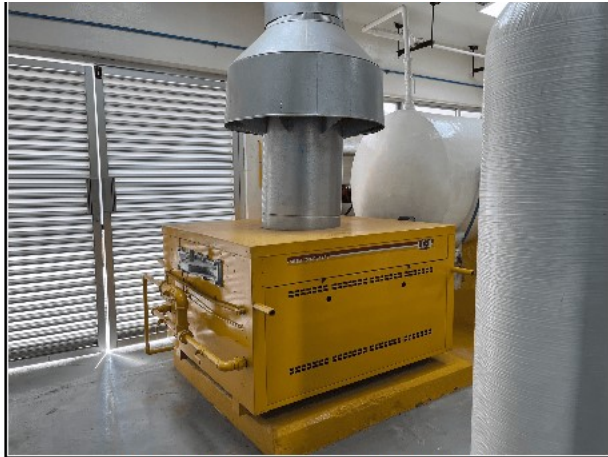
INTERIOR CUARTO DE MÁQUINAS
