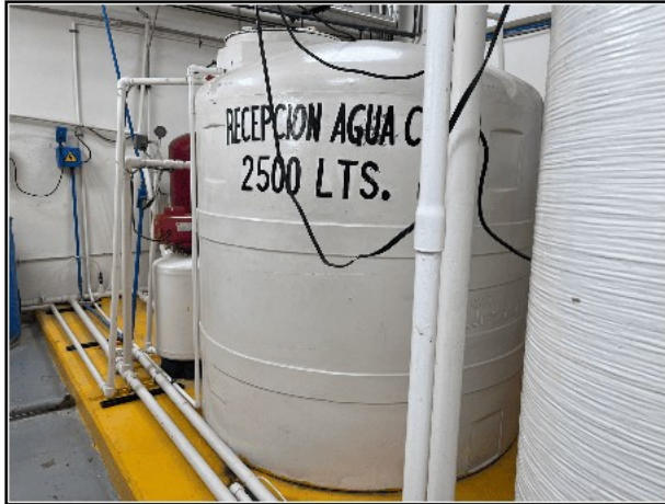
INTERIOR CUARTO DE MÁQUINAS
