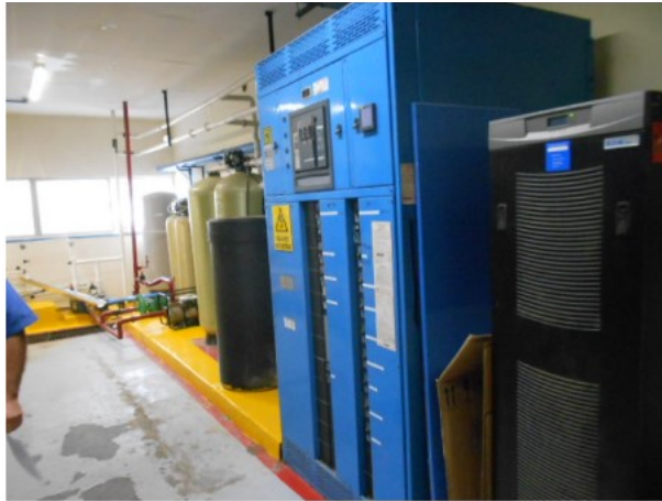
Cuarto de maquinas
