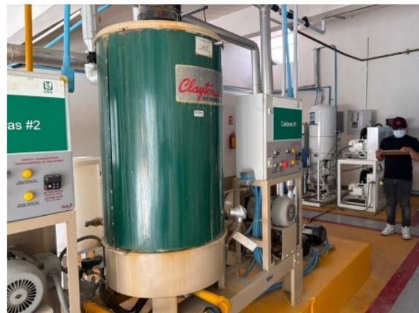
VISTA DE CUARTO DE MÁQUINAS
