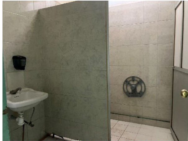
78.- TOMA DEL BAÑO EN URGENCIA. (HOSP.)
