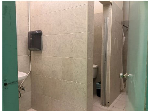
56.- TOMA DEL BAÑO EN HOSPITALIZACION. (HOSP.)
