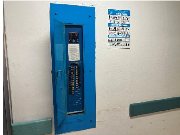
74.- VISTA DEL TABLERO ELECTRICO EN URGENCIA. (HOSP.)
