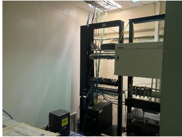
18.- TOMA DEL AREA DEL SERVIDOR. (ADMON)
