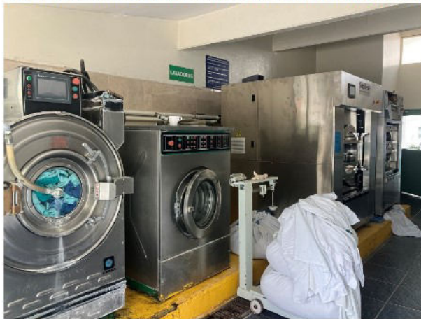
15.- TOMA DEL AREA DE LAVADO. (ADMÓN)
