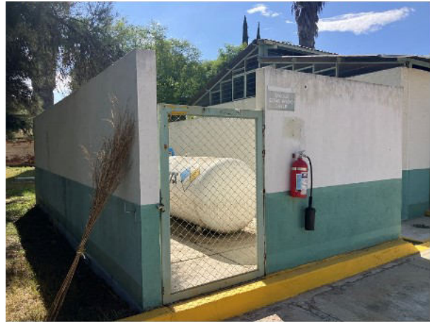
102.- VISTA DEL TANQUE ESTACIONARIO.
