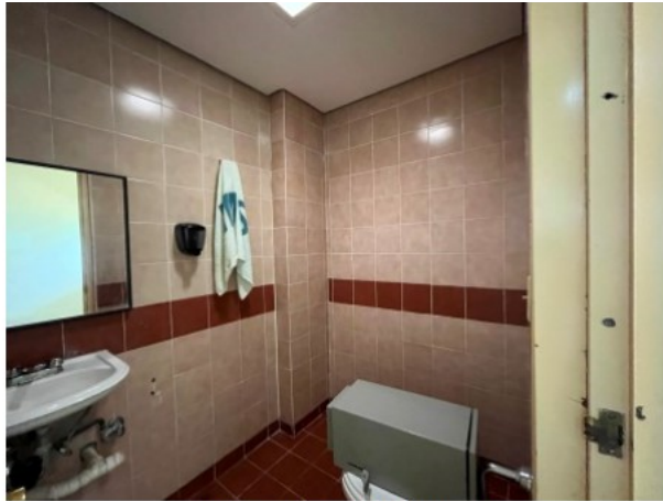
Sanitario del consultorio tipo A
