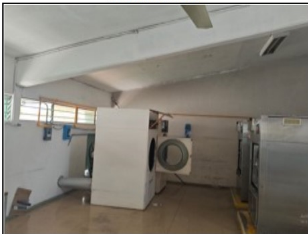
ZONA DE LAVANDERÍA
