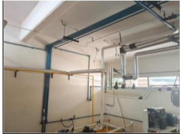
ELEMENTOS DE BOMBEO Y DE SERVICIOS
