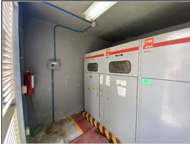
Caseta de Medición
