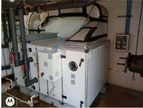
EQUIPO DE AIRE ACONDICIONADO EN AZOTEA.
