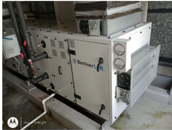
EQUIPO DE AIRE ACONDICIONADO EN AZOTEA.
