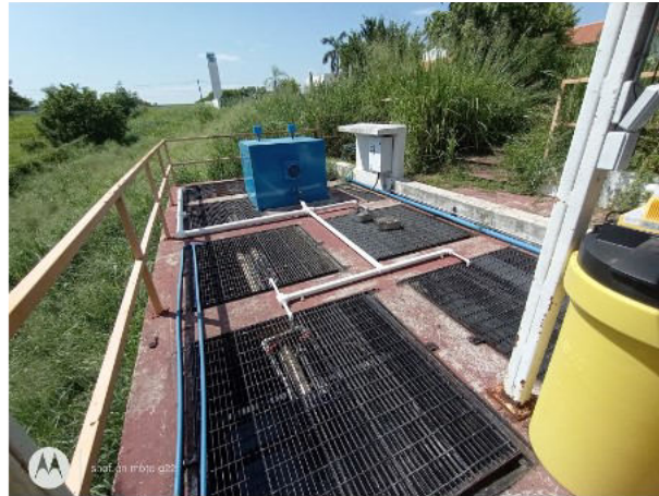
ÁREA DE TRATAMIENTO DE AGUAS.
