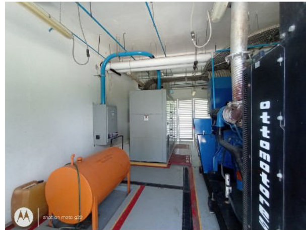
INTERIOR CUARTO DE ALTA TENSIÓN.
