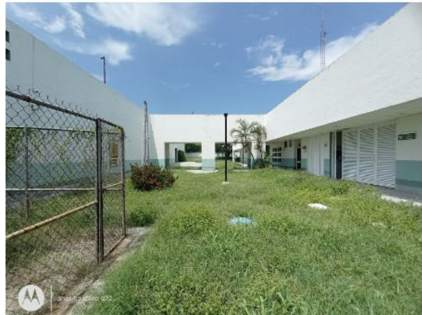
FACHADA SURESTE EDIFICIO 3, PASILLO CUBIERTO ENTRE EDIFICIO 3 Y 1; Y FACHADA NOROESTE DE EDIFICIO 1.
