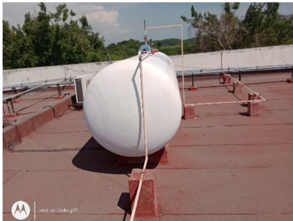
TANQUE DE GAS DE 4930 LITROS.
