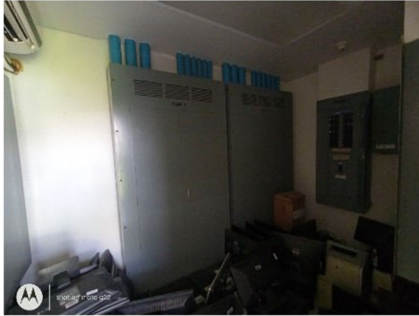
ÁREA TABLEROS SUB-GENERALES.
