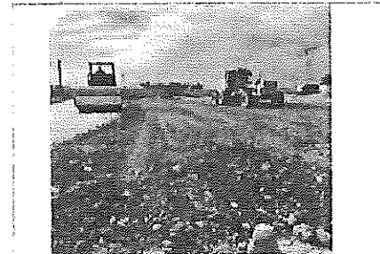
FOTO No. 5: DESCRIPCIÓN FOTOGRAFICA: RELLENO CON MATERIAL DE BANCO ESTA FOTOGRAFIA FUE TOMADA EL DIA 29 DE SEPTIEMBRE 2022.
