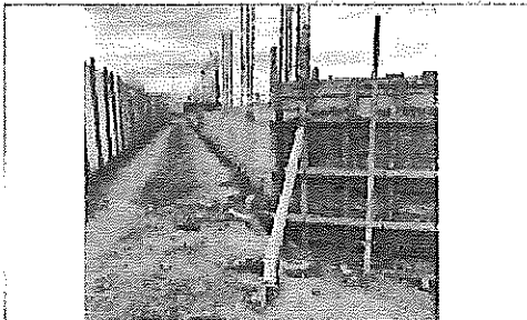
FOTO No. 4: DESCRIPCIÓN FOTOGRAFICA: RELLENO CON MATERIAL PRODUCTO DE EXCAVACION PARA EL AREA EXTERIOR DEL EDIFICIO ESTA FOTOGRAFIA FUE TOMADA EL DIA 28 DE SEPTIEMBRE DE 2022.
