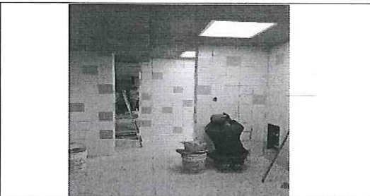
FOTO No. 7: DESCRIPCIÓN FOTOGRAFICA.- CONEXION ELECTRICA DE LAMPARAS EN ÁREA DE ESFINTERES. ESTA FOTOGRAFIA FUE TOMADA EL DIA 30 DE NOVIEMBRE DE 2022
