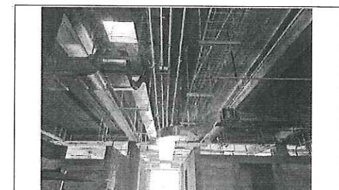
FOTO No. 9: COLOCACION DE TUBERIA CHAROLA Y DUCTOS DE AIRE ACONDICIONADO ESTA FOTOGRAFIA FUE TOMADA EL DIA 29 DE SEPTIEMBRE 2023
